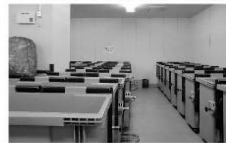
●東西両棟ともに各階から集められたごみ、資源は地下に集約され、区の清掃車及び回収業者によって搬出脱臭装置も完備され、臭いも一切なく衛生的なストックヤード
